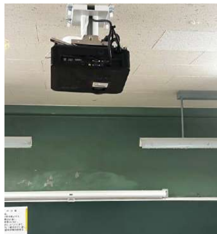
図2 整備された天吊りプロジェクター
