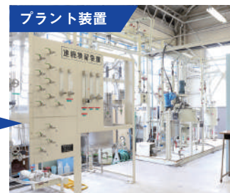
プラント装置
