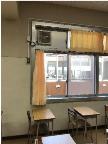
①換気のための換気扇を全教室に設置
