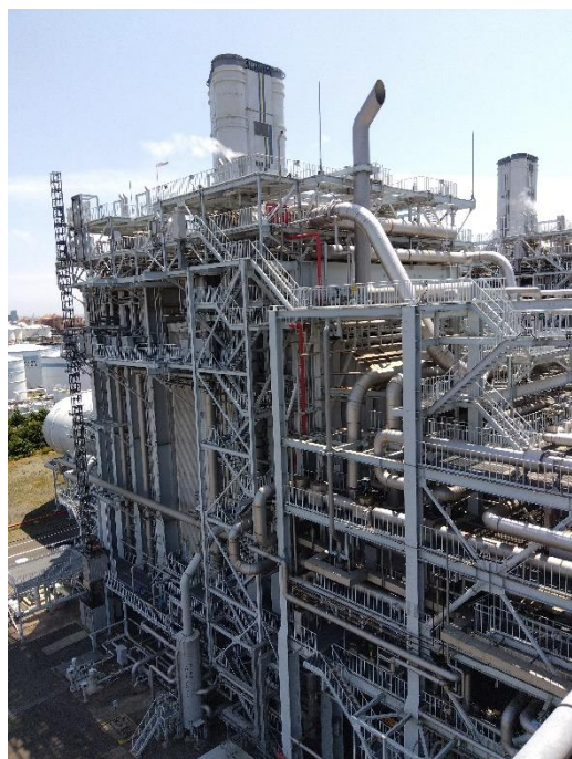
排熱ボイラー
